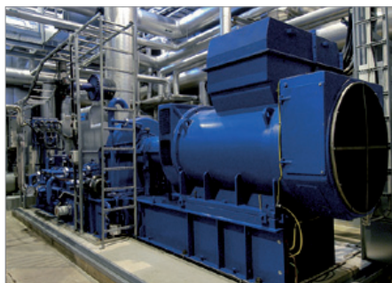
Separatory powietrza Spirotech chronią instalację chłodniczą silników diesla w elektrowni.
